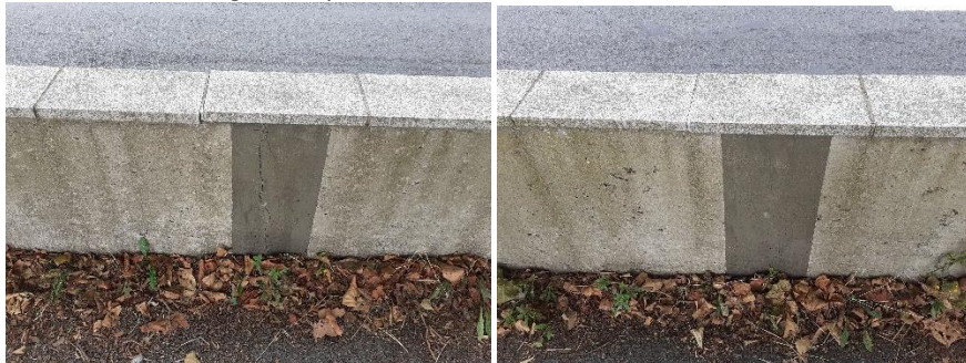
Toiles d'armature et fissures verticales sur les murets béton du SE – SMLCI 02/2024
