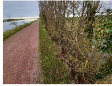
Figure 3-10 : Arbres dans le talus aval
